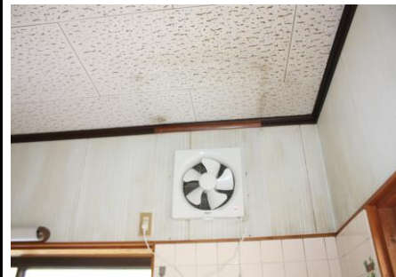
キッチン換気扇周り
