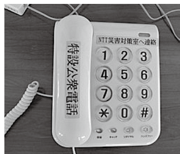
電話の設置が望まれる
