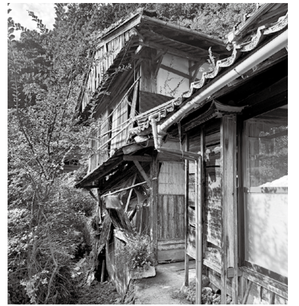
壊れそうな空き家が急増
