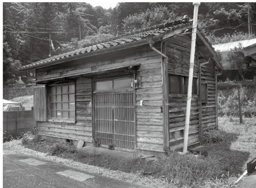
老朽化が進んだ町営住宅
