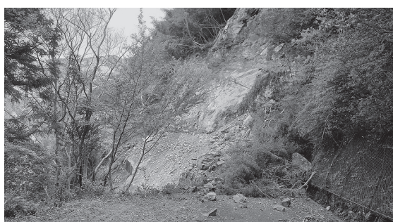
町道鎌井田稲村線の崩落
